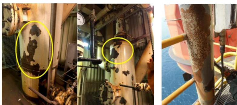
Bilde 1 og 2. Overflater som skal repareres
